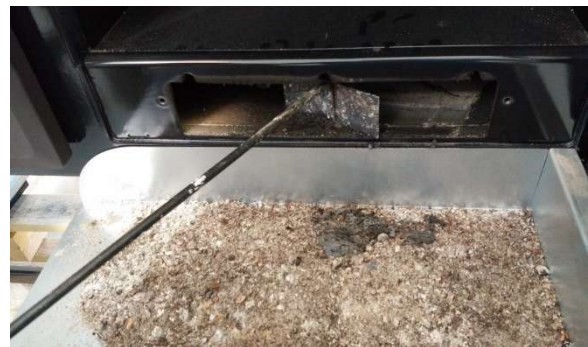
Figura n°22 - Accesos para la limpieza de la salida de humos.
