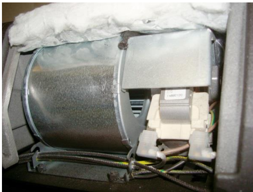
Figura n°28 - Acceso a los ventiladores
